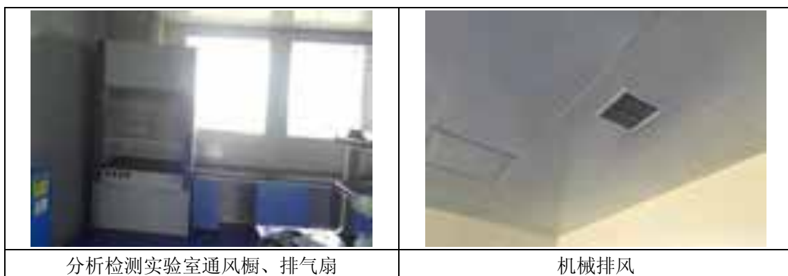
图 4-2 项目废气处理排放措施
